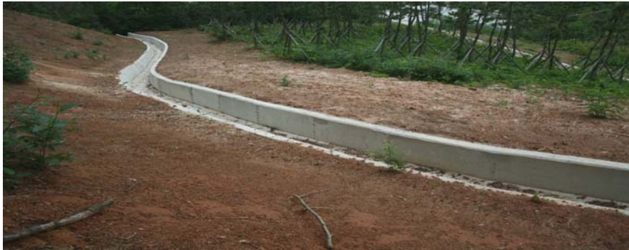
그림 2-28. 생태통로 진입부 배수로에 탈출용 경사로와 덮개가 설치되지 않아 양서·파충류와 소형포유류의 이동이 어려운 사례
