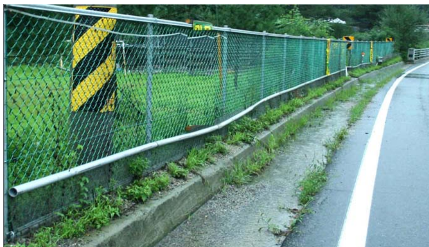
그림 3-24. 잘못된 사례: 상부를 꺾는 대신 PVC 가로대를 설치 하였으나, 도로 안 쪽에 설치하여 양서류가 풀밭에서 도로 안으로 들어오는 것을 예방하기 어렵다.(도로 밖 쪽에 설치하여야 옳음)
