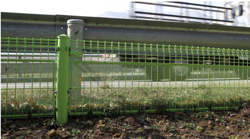
그림 3-26. 양서·파충류 전용 울타리를 설치한 사례 2
