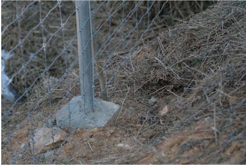
그림 3-34. 울타리 하단부 설치 미흡: 콘크리트 기초가 땅 속에 완전히 묻혀야 울타리 하단부를 지면에 밀착시키거나 땅속에 묻을 수 있다.
